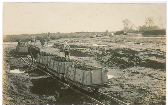
▲大正11年；すべて手掘り工事だった。軟弱な泥炭層なため、トロッコが脱線する事故が多かったという。
